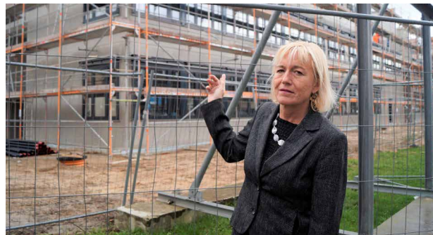
Karin Halsch vor dem im Bau befindlichen Modularen Ergänzungsbau in der Wustrower Straße
